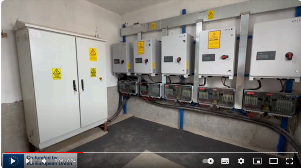
Şekil 1.2: İnvertörün pano içerisine kurulumu
