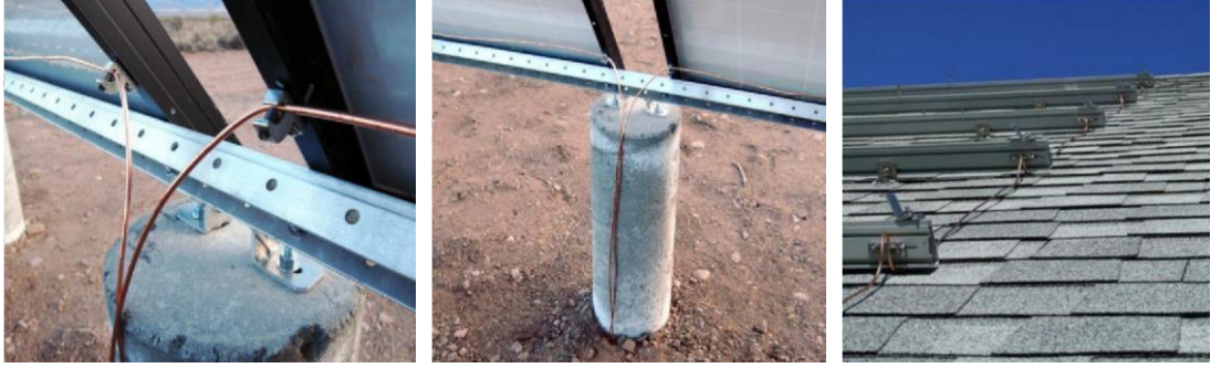
Resim 1.7: Açık alanlarda ve yapılarda güneş panellerinin topraklanması
