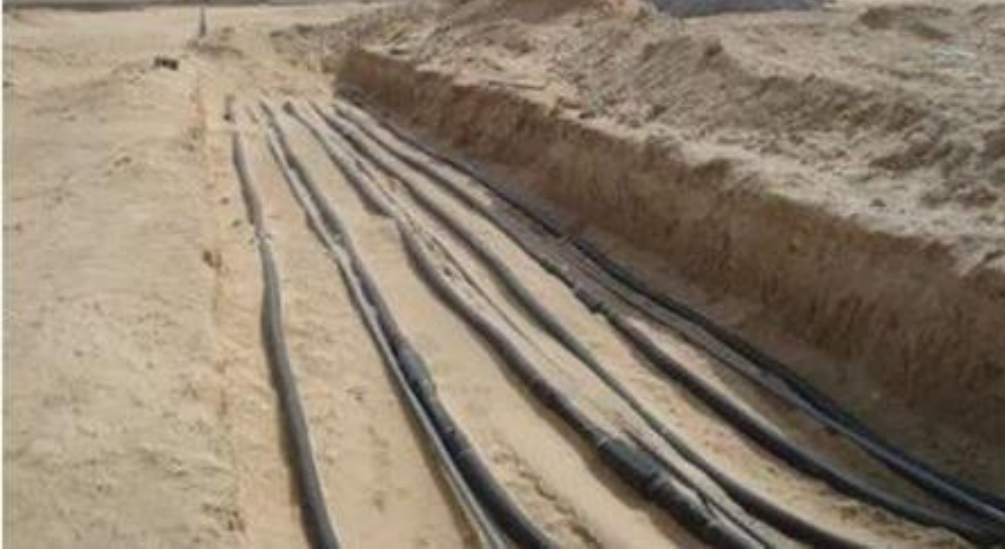
Resim 1.1: Güneş enerji santralinde kanal içerisinde yan yana dizilmiş güç kabloları
