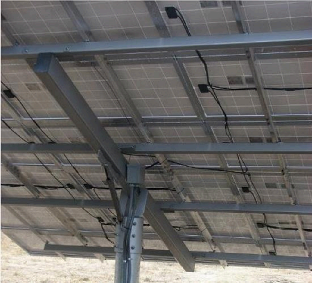
Resim 4.6:Paneller arası kablo geçişleri
